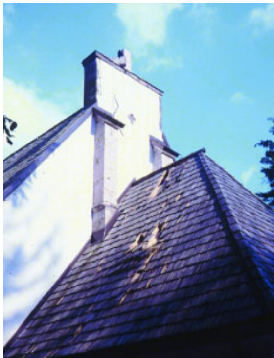
Slika 6.1.5. Najštevilnejše poškodbe so bili odlomi dimnikov, ki so poškodovali strešno kritino. Potres ni prizanesel niti sakralnim objektom; poškodovana cerkev pri kampu v Bovcu, kjer je odpadli zvonec poškodoval strešno kritino. (foto Renato Vidrih)
