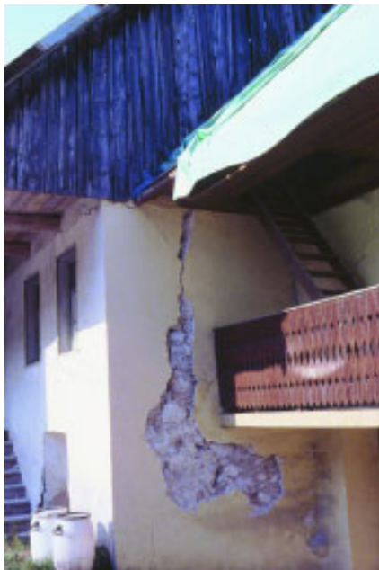
Slika 6.1.3. Močno poškodovana hiša v Čezsoči. (foto Renato Vidrih)
