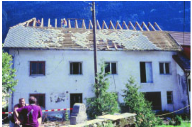
Slika 6.1.10. Slabe lokalne seizmogeološke razmere so v nekaterih predelih Čezsoče povzročile prirastek potresnih učinkov za celo stopnjo. Nekatere močno poškodovane objekte je bilo potrebno podreti. (foto Renato Vidrih)
