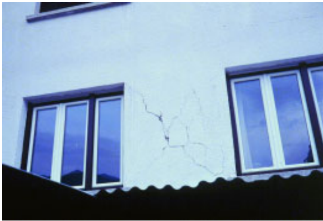
Slika 6.1.9. Diagonalne razpoke v stanovanjskem bloku na Brdu v Bovcu. (foto Renato Vidrih)
